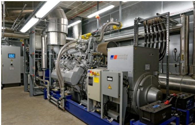
Blockheizkraftwerk beim Gartenbaubetrieb
