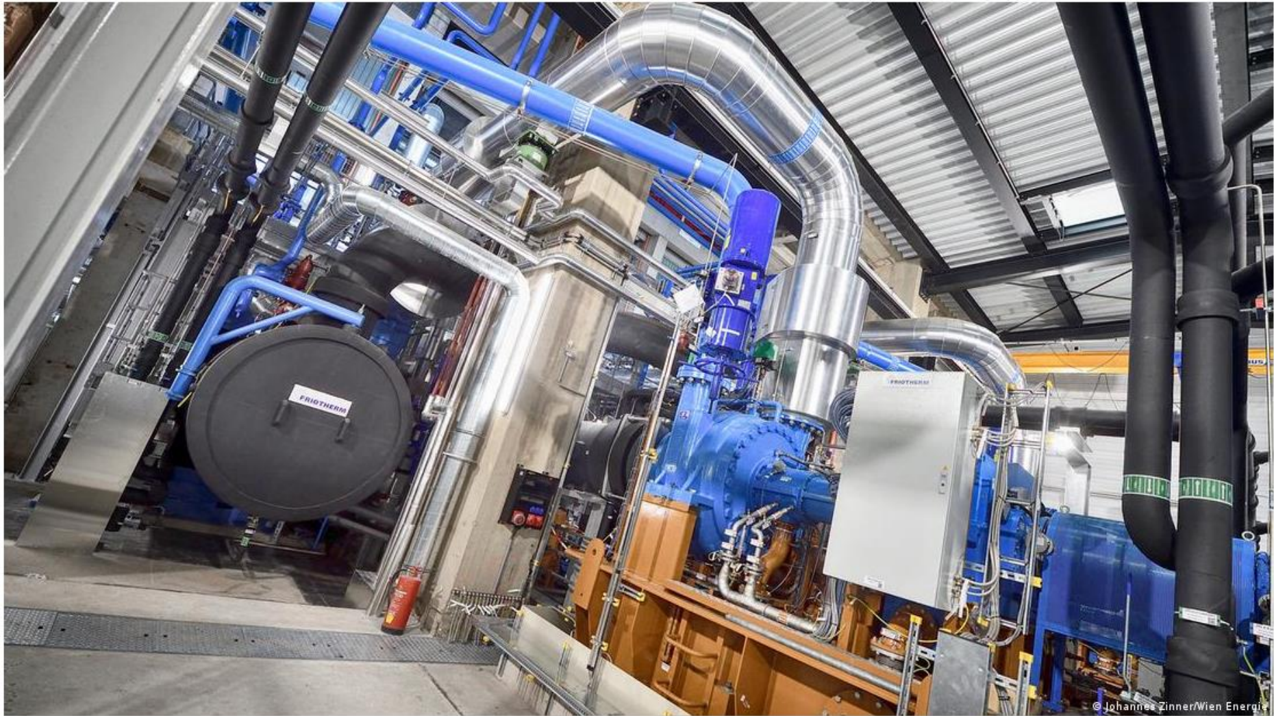
Großwärmepumpe in Wien für 25.000 Haushalte: Sie nutzt die Abwärme von einem Kraftwerk und produziert damit bis zu 95 Grad heißes Wasser für die Fernwärme
