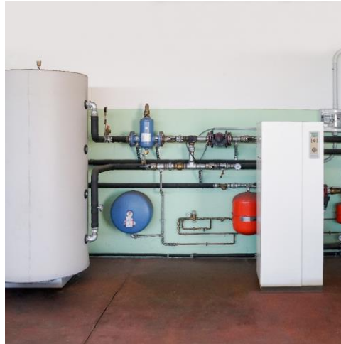
Monitoring und Optimierung der Heizungsanlage
